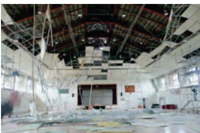
他都市の天井脱落の様子
