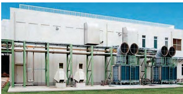
中部下水処理場に導入した消化ガス発電設備
