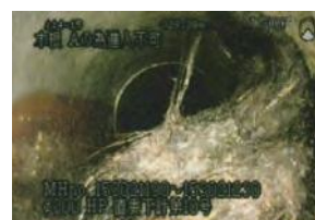
管内詰まり (木根侵入)
