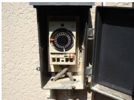
外灯等を自動点滅するタイマー (屋内にある場合もあります)
