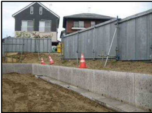
【写真 1 3】店舗と近隣住宅境界 (店舗東側)
