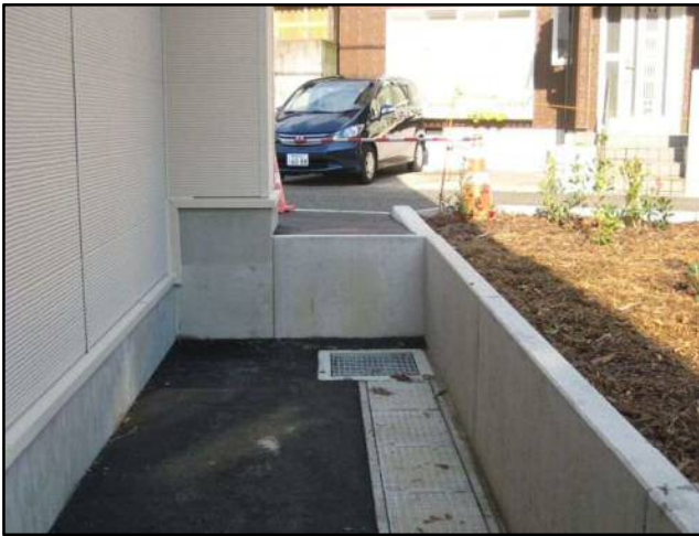
歩行者用出入口(階段未設置)
