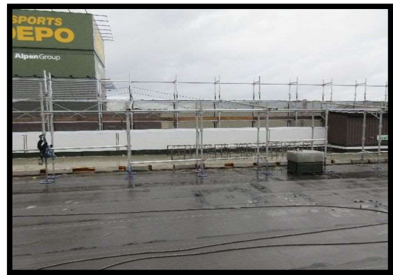
【写真⑭】 屋上室外機置場
