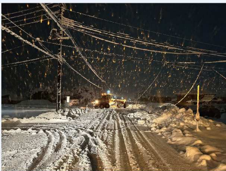
実際に発生した電線類の垂れ下がりの様子
