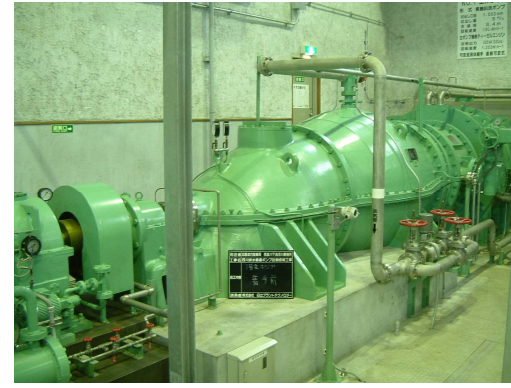
主ポンプ 外観
