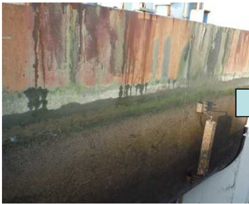
扉体発錆状況
