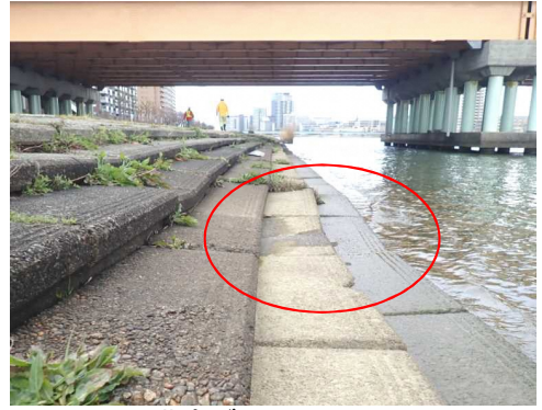
護岸ブロックの沈下
