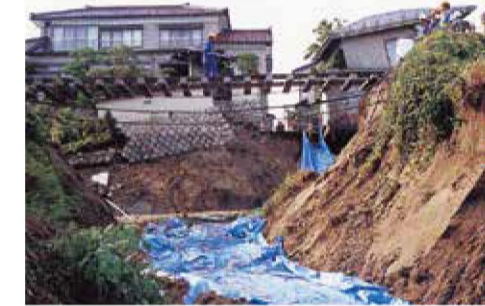
平成10年8月4日の大雨による「がけ崩れ」の様子 市内の市街地で集中豪雨によりがけ崩れが発生したものです。
