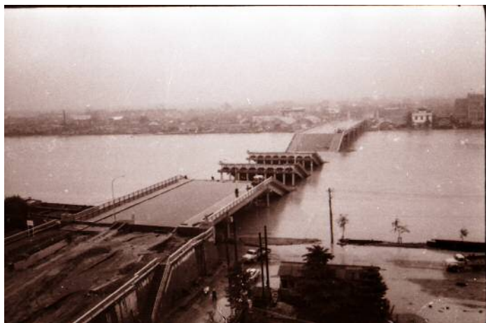
写真 1-1.1 新潟地震による被害
