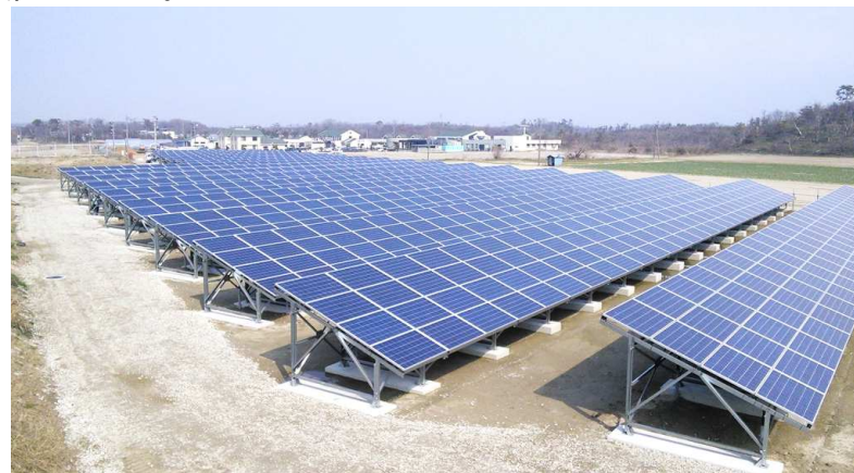
中村浜発電所(発電出力 750kW)
