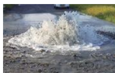
水道管が腐食して漏水した道路
