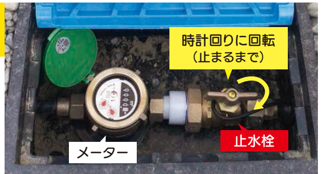
水道メーターボックス内の止水栓
