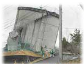
東北地方太平洋沖地震の余震により倒壊した配水塔 (岩手県) 出典：厚生労働省
