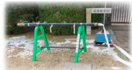
応急給水設備
