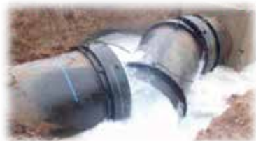
東北地方太平洋沖地震による送水管の抜け出し (φ2400mm) (宮城県) 出典：厚生労働省
