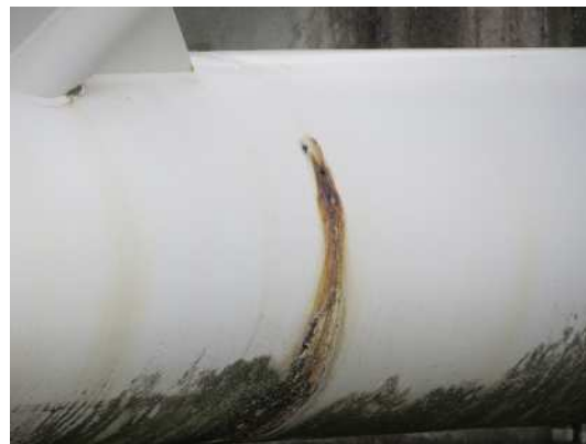
(a) 腐食部位
