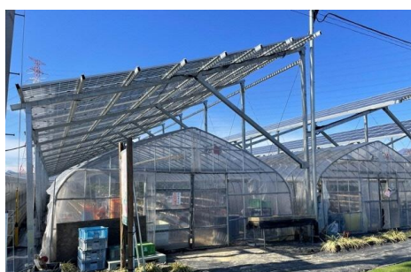
ハウス上部の太陽光パネル
