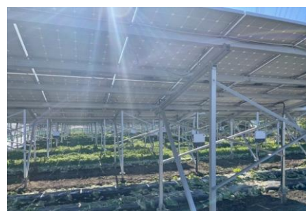
露地上部の太陽光パネル
