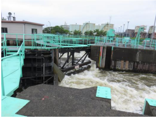
山の下閘門の扉が開き中に水が流れ込んでくる。
