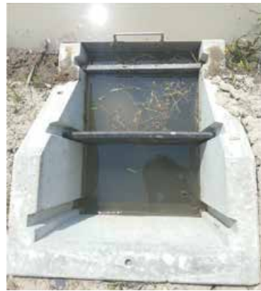
写真 2.1 大形工区の垂直設置型調整板用の排水マス
