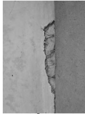
・塗籠戸の下部に破損が見られる
