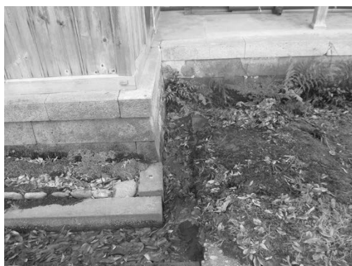
落葉や泥が堆積した排水路
