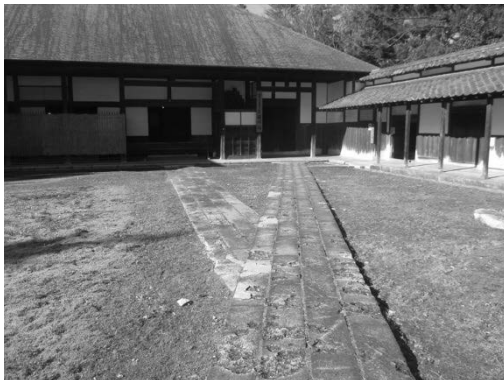
劣化が進んでいる切石
