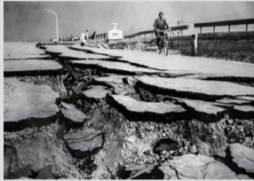
昭和大橋地割れる
