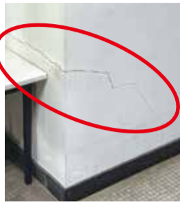
▼1階柱のひび割れ
