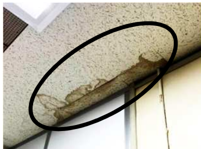
B棟1階 授乳室入口の雨漏り
