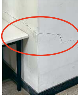
▼1階柱のひび割れ
