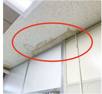
▼1階天井雨漏り
