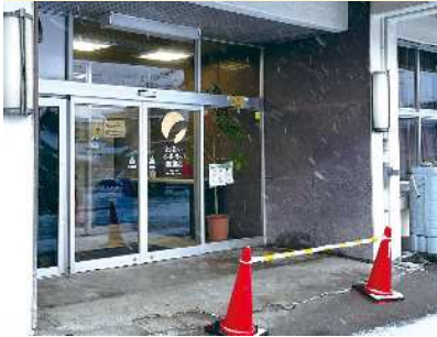
▼地震の影響により封鎖している南側入口
