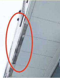
▼おもいやり駐車場側外壁コンクリート一部剥離
