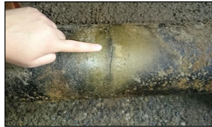
写真2 漏水したCIPの管体部
