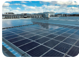
◀中央卸売市場の屋根に設置されている太陽光パネル
