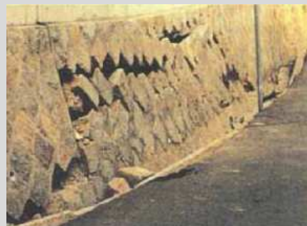
③擁壁の崩壊
