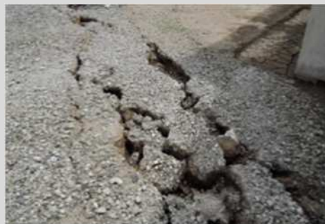
②地盤の亀裂
