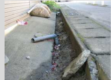
地盤の沈下・段差
