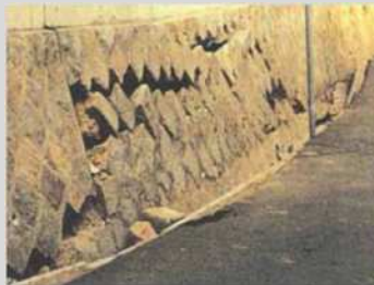
擁壁の不同沈下・目地の開き
